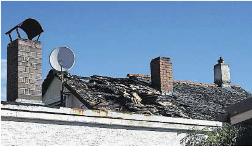
Der Dachstuhl wurde durch das Feuer stark beschädigt.
